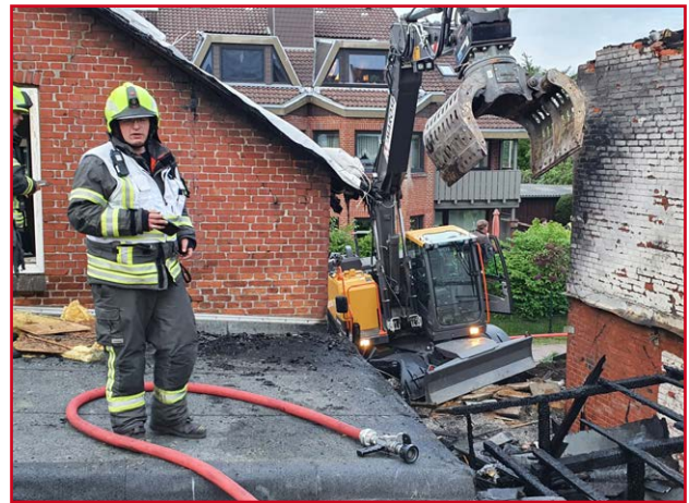
Das Gebäude musste aus Sicherheitsgründen abgerissen werden.
